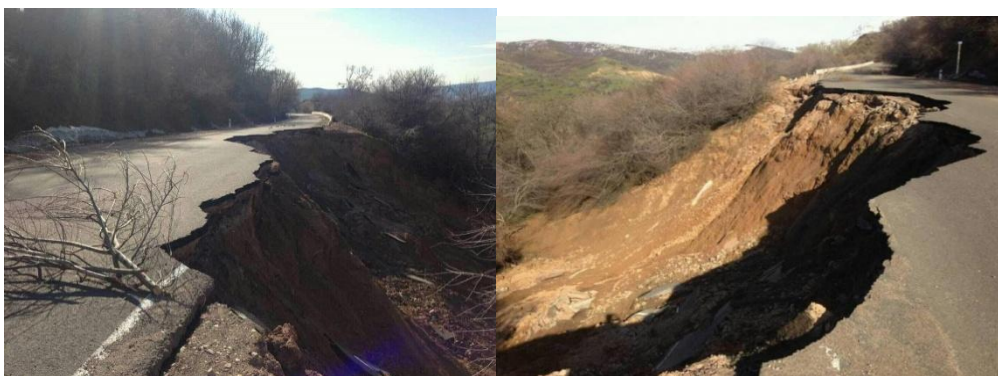
Рисунок 2. Влияние оползневых явлений на автомобильной дороге
