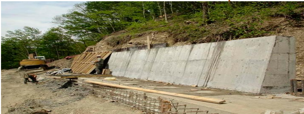
Рисунок 3. Искусственные сооружение от оползни в горных местах
